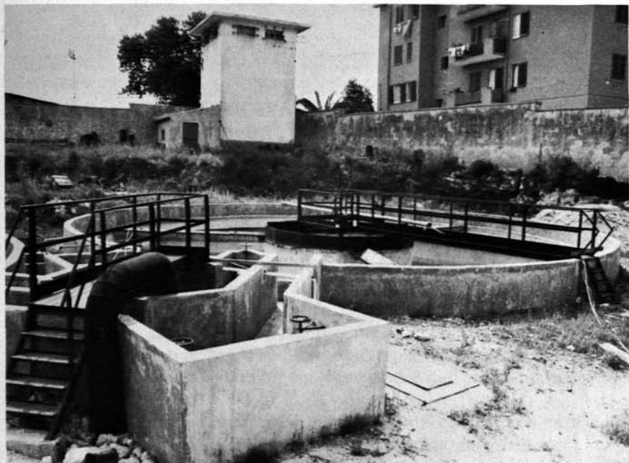
Uno degli impianti di depurazione dell'acquedotto civile di Sassari.
