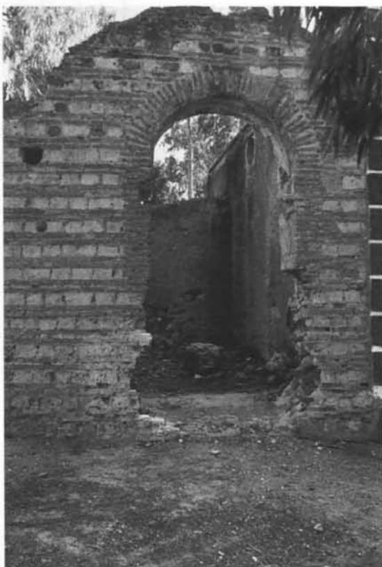
Fig. 134 - Vallermosa. Santa Maria: porta d'accesso creata con lo sfondamento della parte sottostante una finestra dell'edificio termale.
