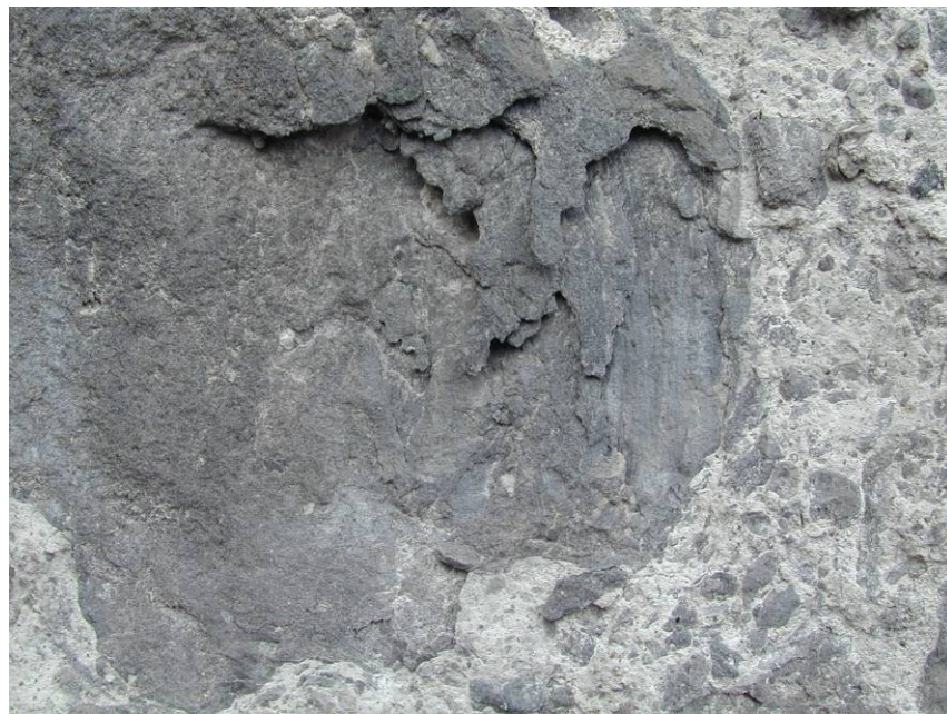
Fig. 3.3 - Villa Pignatelli, Napoli - Piperno: esempio di disgregazione.
