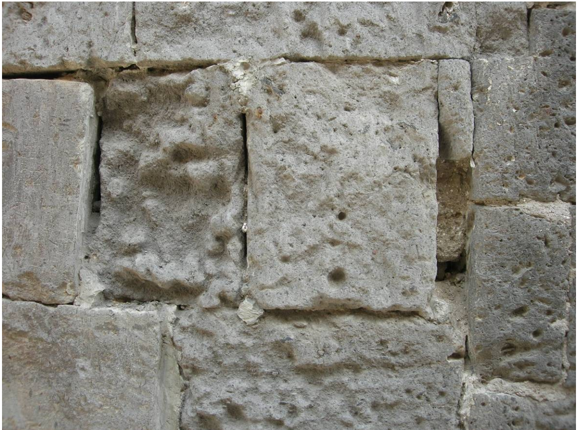
Fig. 3.12 - Cattedrale di Casertavecchia - IC_{gr} : esempio di disgregazione e alveolizzazione.
