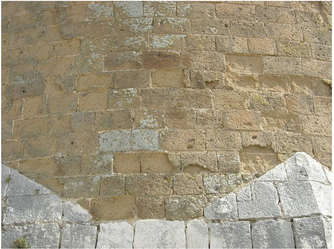
Fig. 3.11 - Casertavecchia, Mastio del Castello - IC_{gi} : esempio di disgregazione con arretramento della superficie e efflorescenze.
