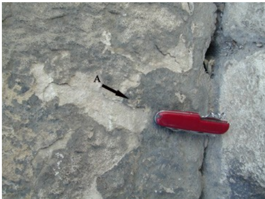
Fig. 3.6 - Calcare: esempio di patina che si manifesta con una variazione del colore originario del materiale.
