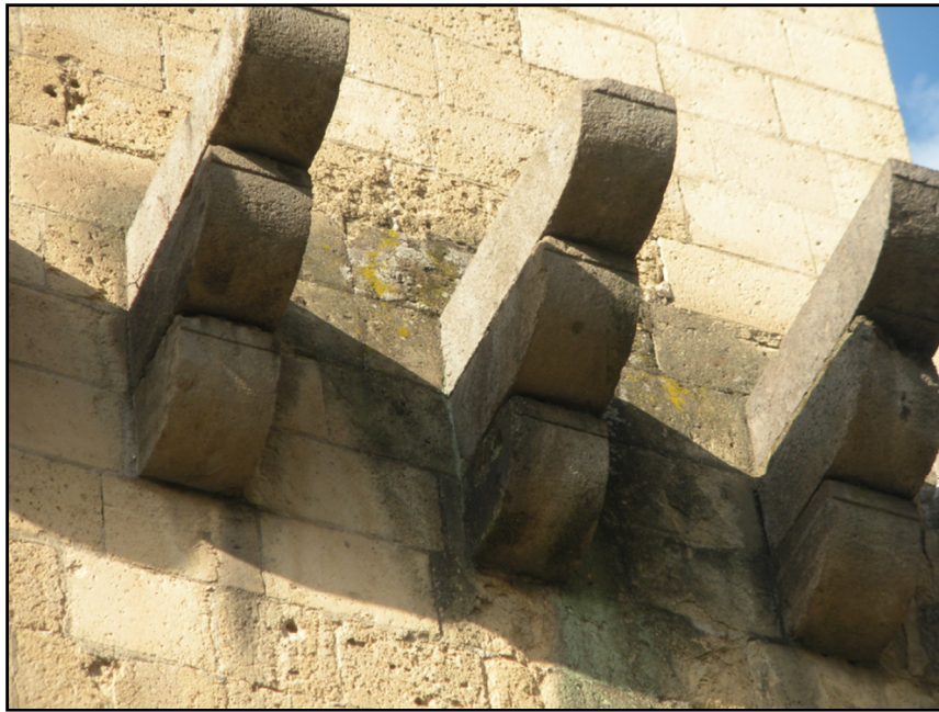
Figura 2.16 – Alterazione biologica sulla facciata principale della Basilica di S. Chiara (Napoli).
