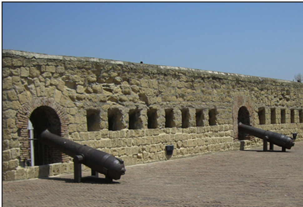
Figura 2.15 – Disgregazione in conci di TGN delle mura del Castel dell'Ovo (Napoli).
