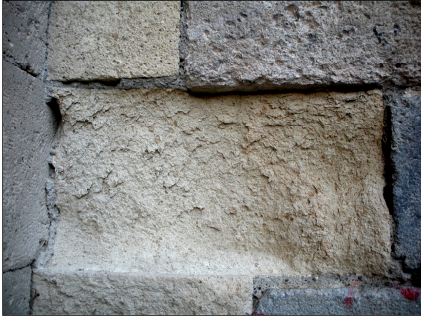
Figura 2.14 – Scagliatura in conci di TGN della facciata laterale della Basilica di S.Chiera (Napoli).
