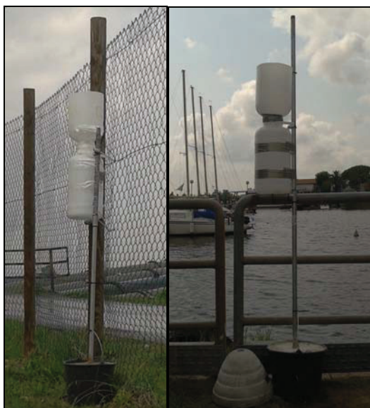
Figura 3.1.6: Deposimetri dotati di strutture di sostegno, a sinistra alloggiato all'idrovora di Massaciuccoli, a destra a Torre del Lago.
