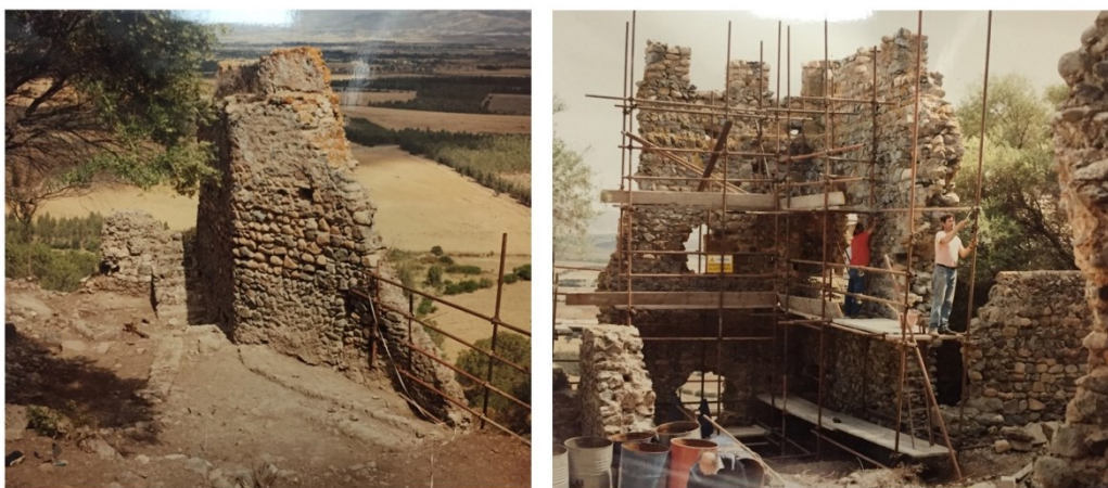
Figure 79-80: Foto del cantiere relativo al II stralcio esecutivo del 21/2/95 con interventi che interessarono la cortina muraria difensiva (ASBEAP_CA-OR)
