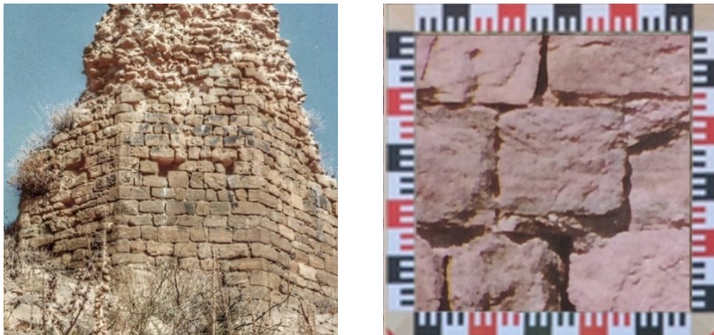
Figura 48-49: Foto della torre decagonale del Castello di Barumele e particolare della tessitura del paramento murario costituita da conci squadrati (ASBEAP_CA-OR)
