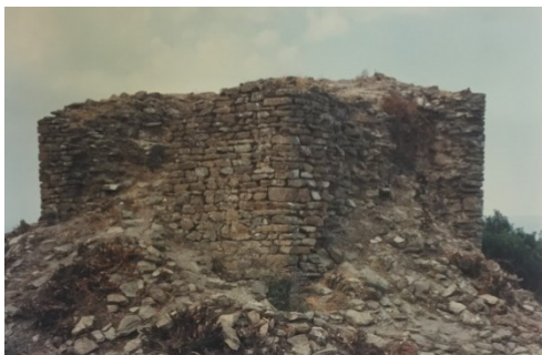
Figure 85-86: Foto che mostrano le murature oggetto di reintegrazione con malta povera a base di calce ed inerti del sito, additivata con piccole quantità di cemento bianco e terriccio vagliato (ASBEAP_CA-OR)
