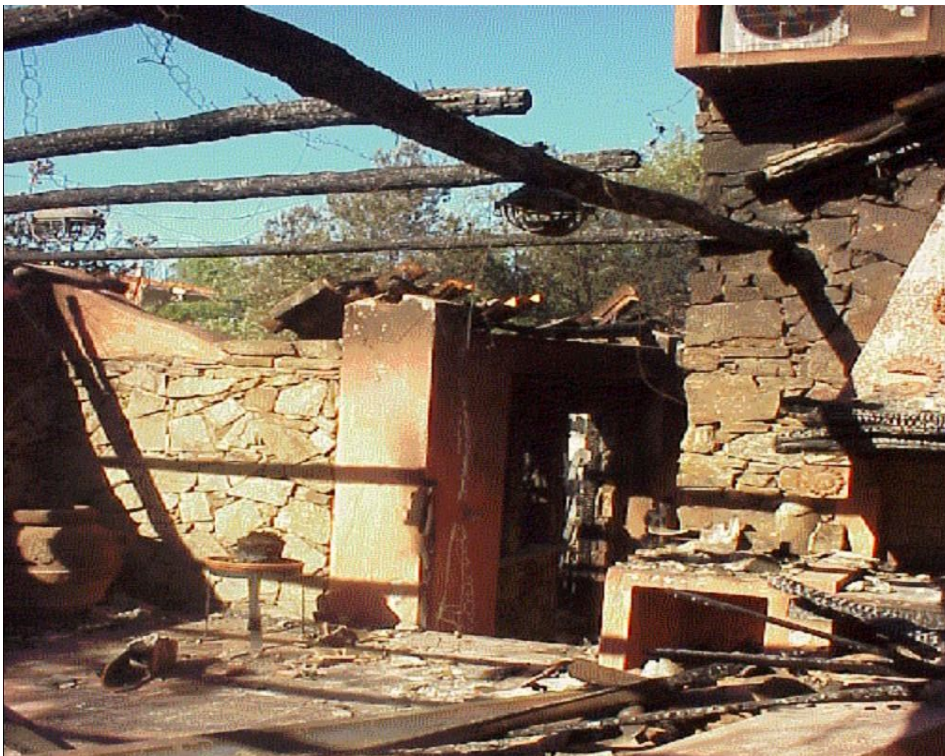
Figura 18. Struttura abitativa danneggiata dall'incendio di Baia Caddinas, Golfo Aranci 2004 (fonte CFVA).
