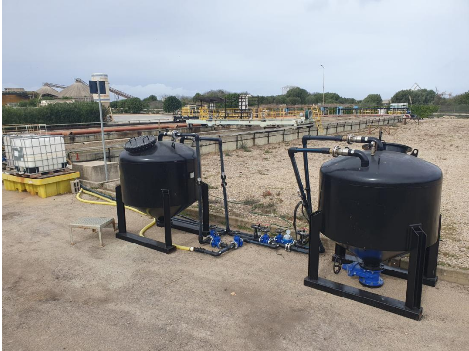
Figura 21: Filtri AquaFlow™ 2000 della Jacobi Group installati all'uscita dell'API4 per la sperimentazione con GAC. Sulla sx è presente il filtro caricato a quarzite, a dx il filtro a GAC.
