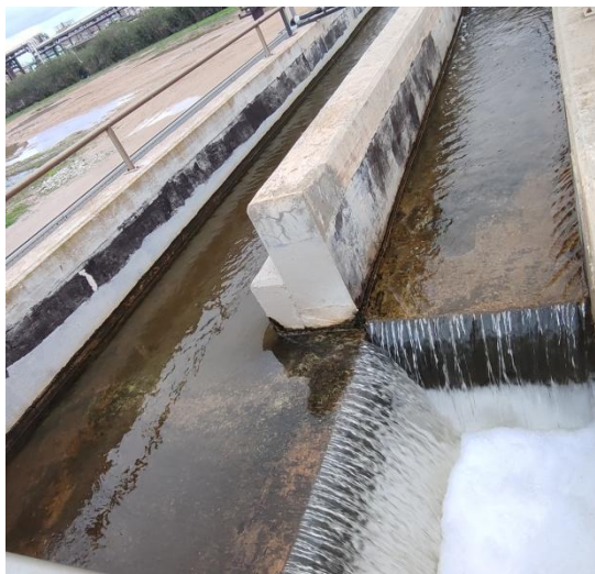
Figura 10: Scarico finale acqua depurata in uscita dalla sezione terziaria di filtrazione e disinfezione.
