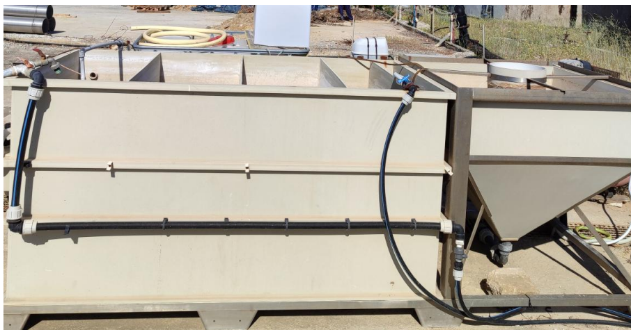
Figura 25: Impianto pilota utilizzato per il processo di chiariflocculazione
