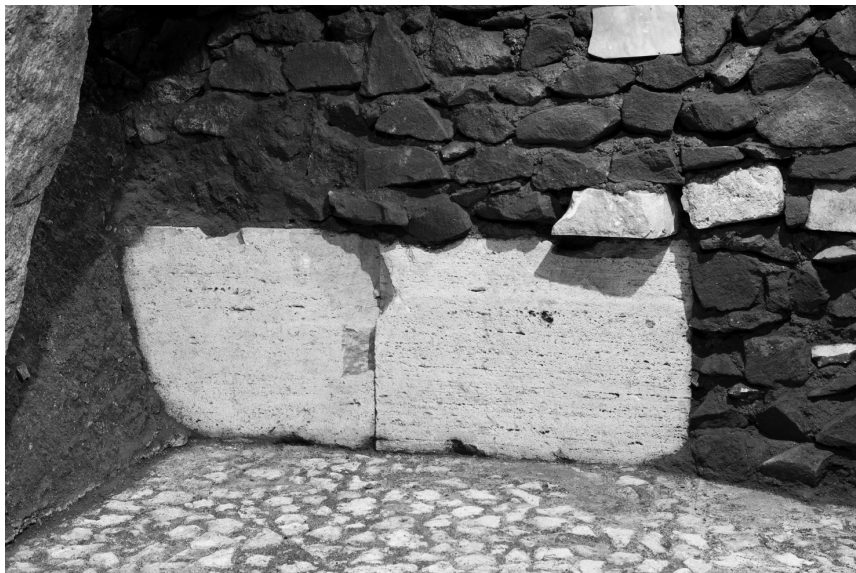
FIG. 8 Ex carceri, ambiente 42-43, blocchi di travertino in appoggio sulla piattaforma in opera cementizia (foto ACC).
